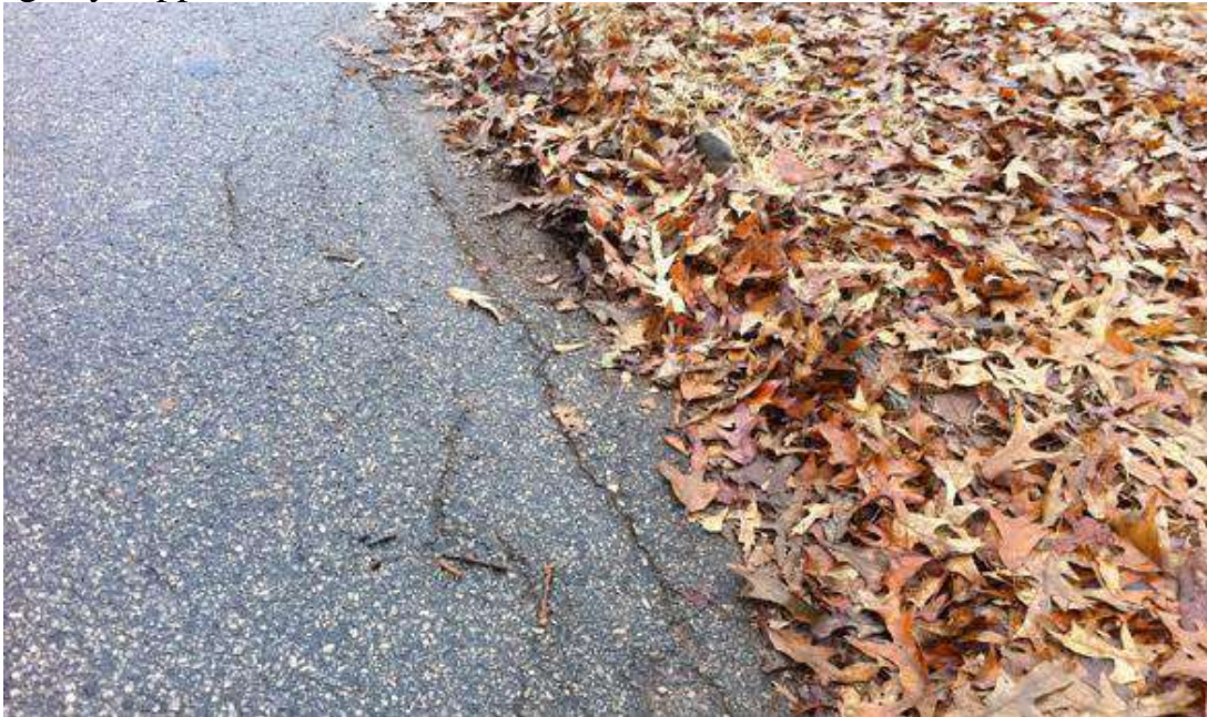
Fig. Edge Cracks
