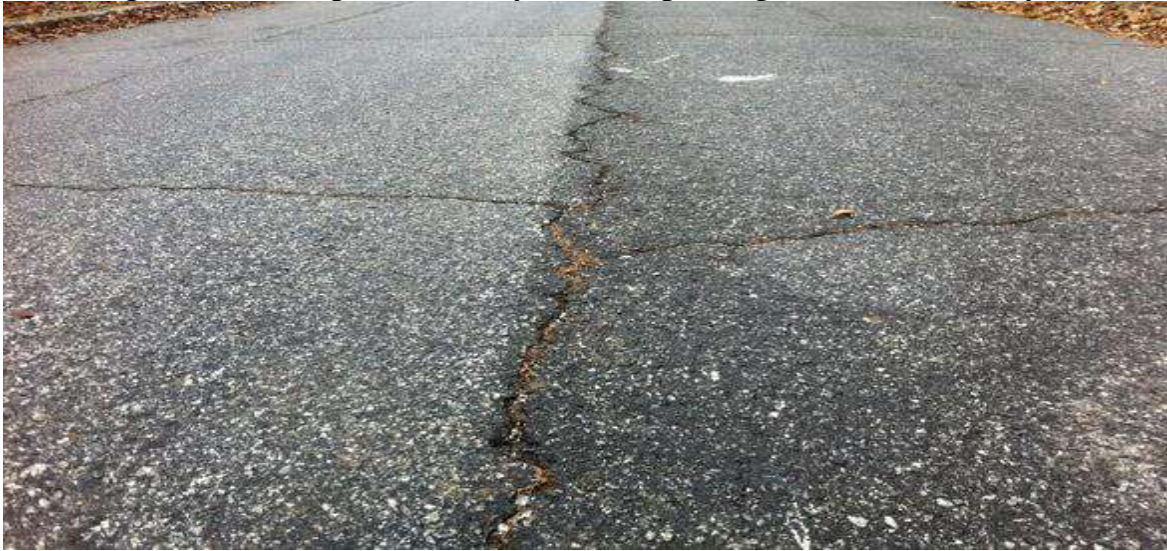
Longitudinal (Linear) Cracking
