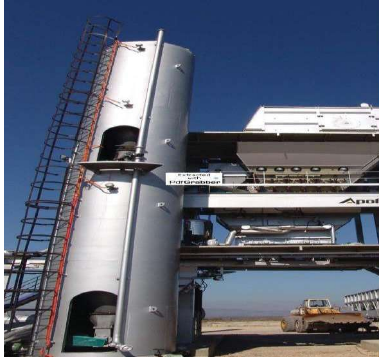
Fig. Mineral filler unit
