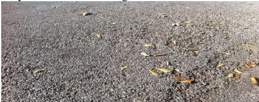
Fig. Raveling (very porous asphalt)
