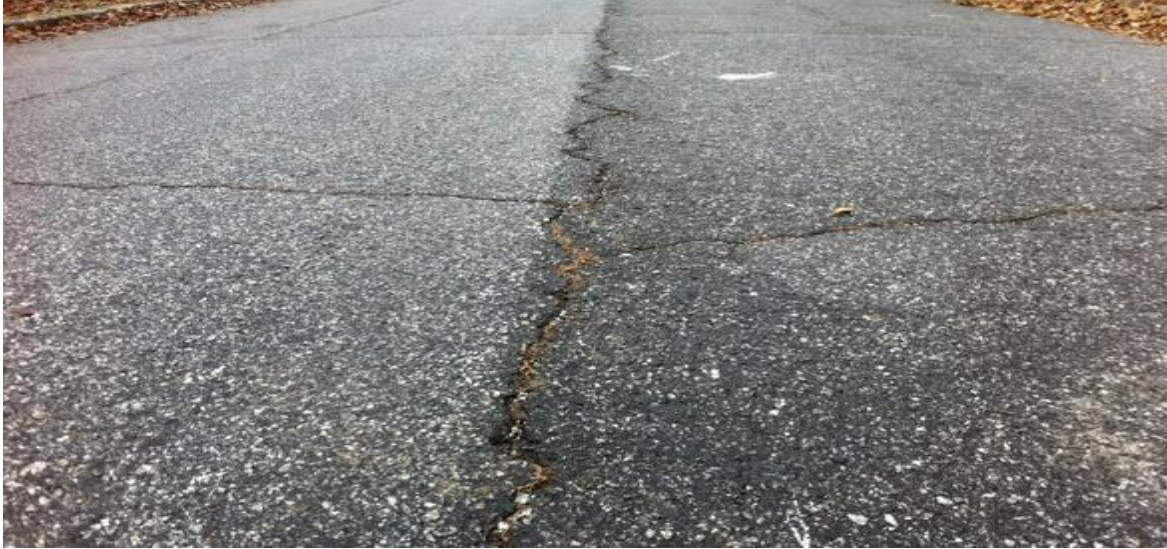
Longitudinal (Linear) Cracking
