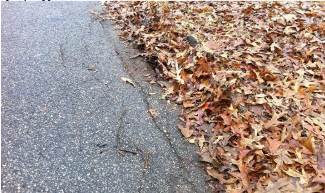
Fig. Edge Cracks
