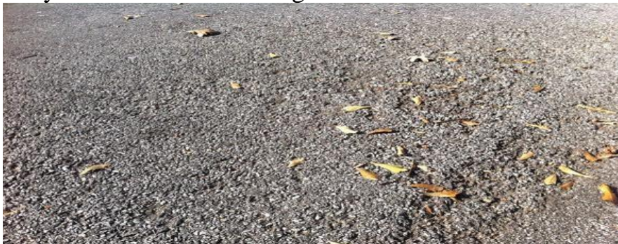
Fig. Raveling (very porous asphalt)
